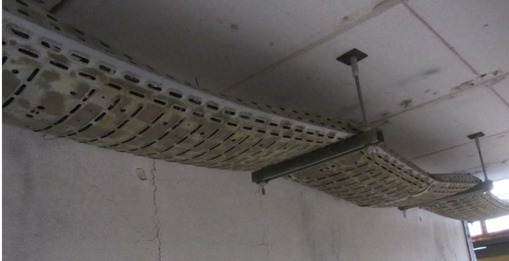
Bild 2: Verformte Kabelrinne nach Brandprüfung (Brandbeanspruchung 30 Minuten)
